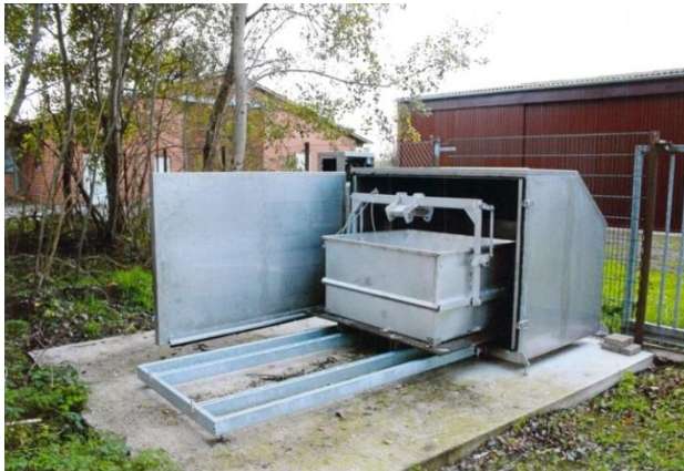
Abbildung 28: Oberirdische Kadaverlagerung in Kühlung mit Schienensystem zum leichteren Handhaben. Befüllen des Containers von der Hofseite ©LMG Nord
